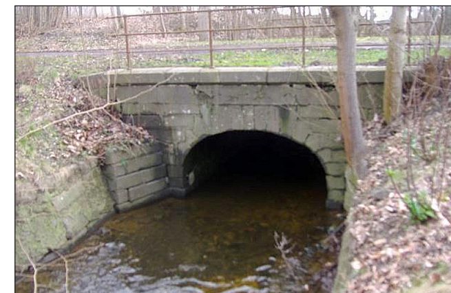
Nordsiden af broen over Skovse Å. Marts 2017. På den ene facade står der "kongekrone C VII 1781" og "SKOVSE" på den anden side.
